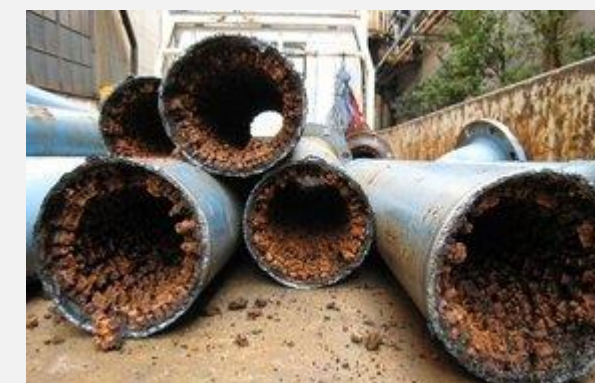
配管の老朽化
